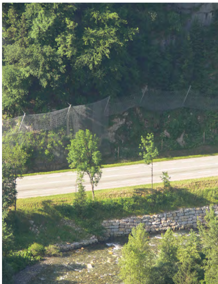
La RD 909 soumise aux aléas (chute de pierres et érosion du Fier).
